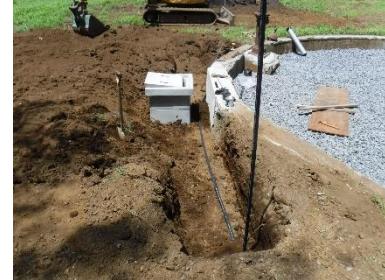
③給水管を埋設している。今回は水道管との接続は別工事となった。
