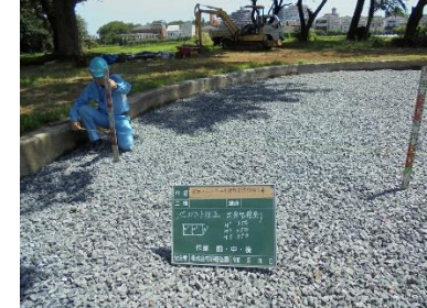
④池のかさ上げは、池の擁壁天端から約35cm下がりにするようにした。
