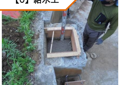
①施工前 池の出島みたいな箇所に共用栓を設置するための基礎づくり。
