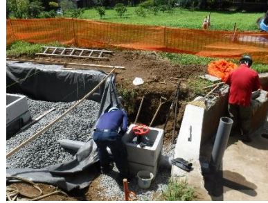
④擁壁と浸透ますの間には排水バルブを設置している。
