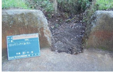
①施工前 壊れて開口している、池の躯体（壁）。
